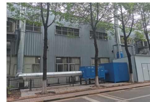
轨道交通事业部空簧车间硫化废气 无组织废气治理
