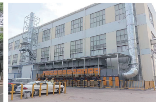
风电光明工厂油漆废气治理工艺 升级改造
